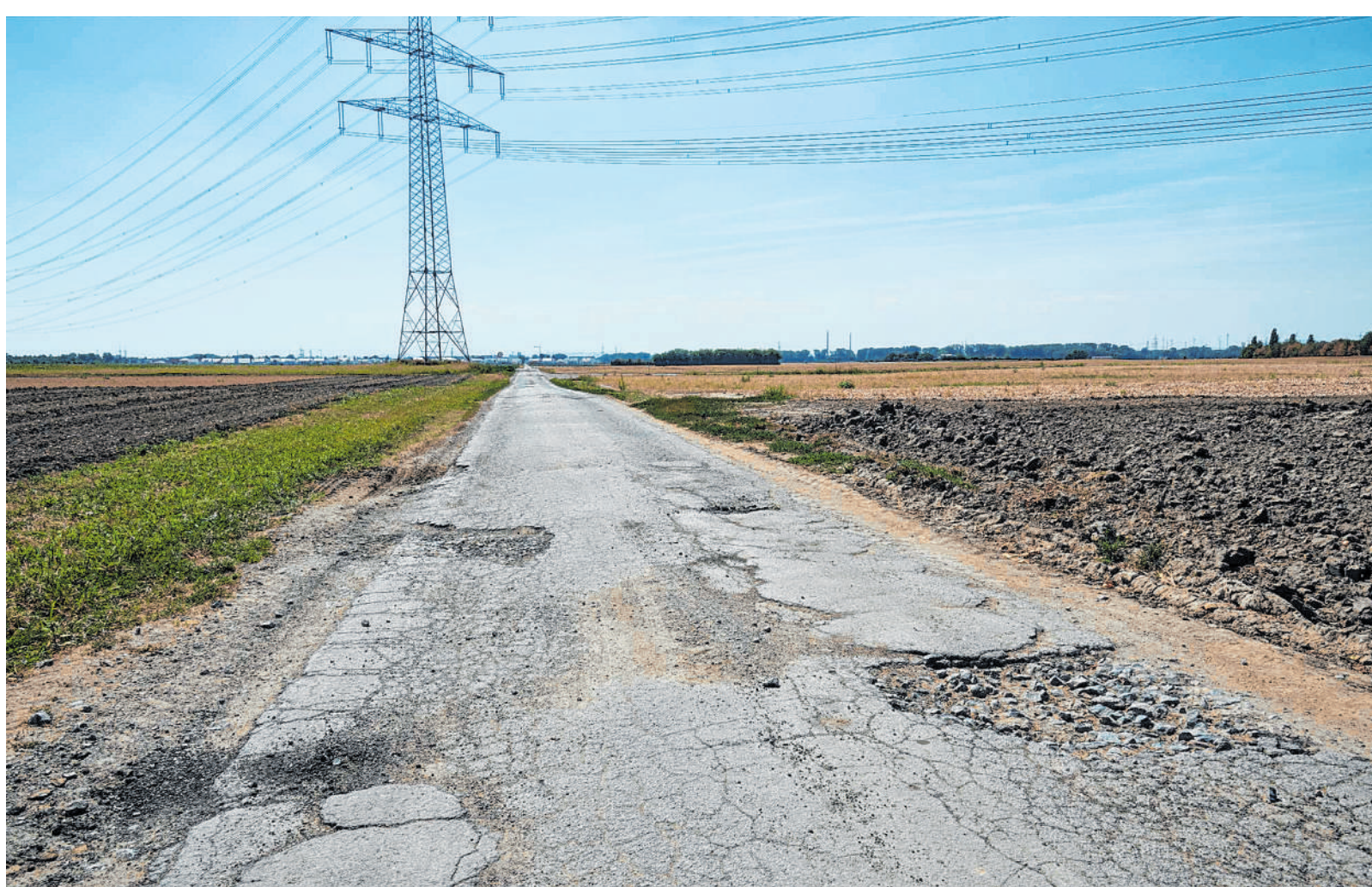
Der Feldweg L-B-06 in Hofheim ist in einem schlechten Zustand – er ist allerdings für die Zufahrt zur Deichverteidigung notwendig. BILD: NIX
